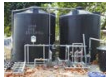
◀ 調節控制設施
