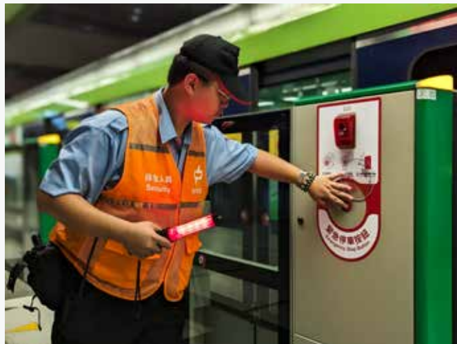
捷運月台新設緊急停車按鈕
