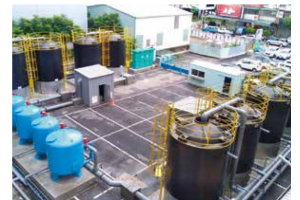
工地過濾地下水之淨水設備
