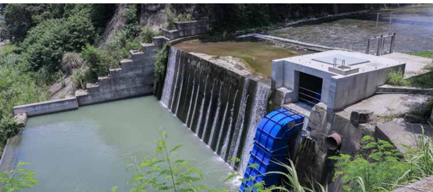
食水料溪小水力發電廠可生產1,000張綠電憑證，啟用後將成綠能商機
