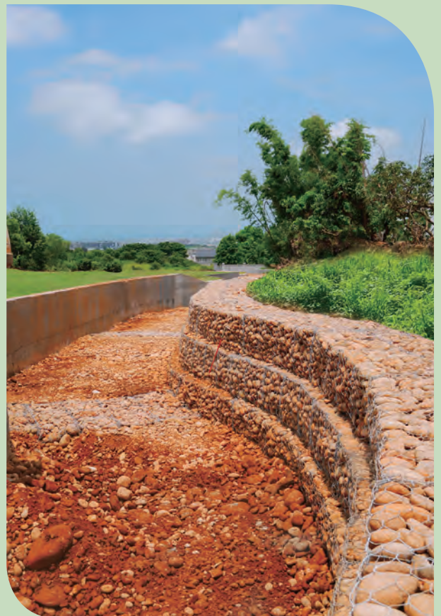
▲ 南勢溪(六晉橋下游)設置石籠護岸，一邊採用混泥土，一邊施以生態工法。
