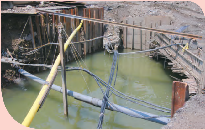
▲大里區大峰路雨水下水道改善工程今年已完工，施工中遇到多項管線阻礙。
