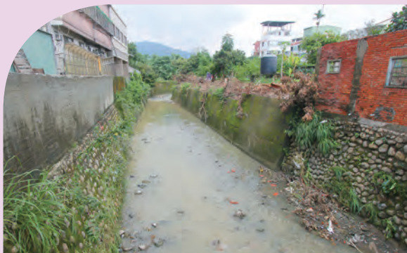
▲坪林排水舊土堤護岸防洪力低。
