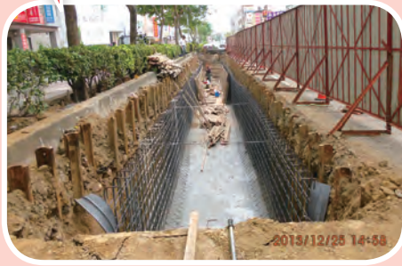
烏日區中山路一段雨水下水道
