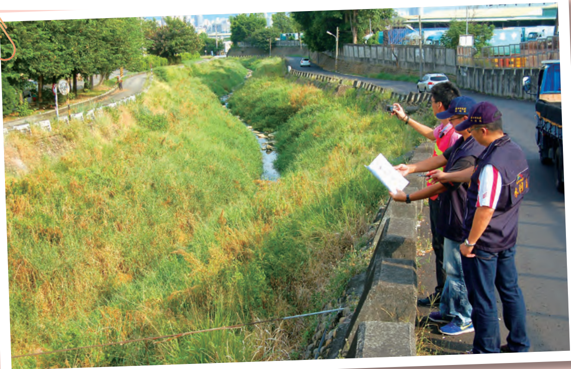
▲ 河岸阻塞物雜草巡查(東大溪)，後通報派員清理。
