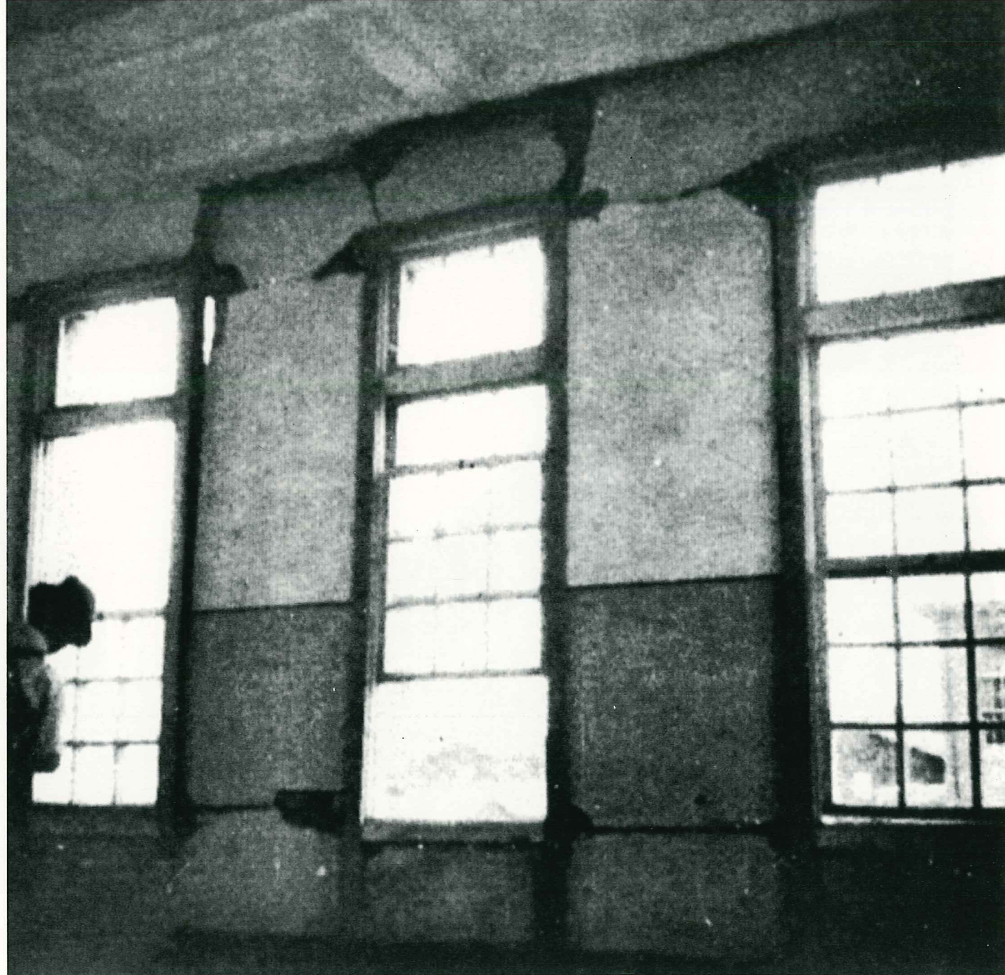
沙鹿庄役場（鎮公所）二樓內部牆壁龜裂 1935
