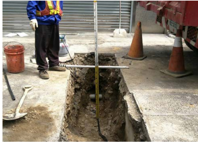
施工人員若發現資料與現場不一致，可透過回報記錄機制更新圖資。
