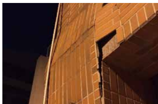
外牆磁磚剝落
