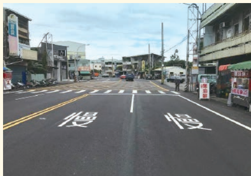
上圖 東平路一段路平工程採「半半施工」方式，降低對當地交通的衝擊。
