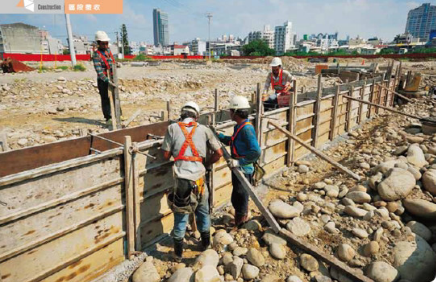
水湳區段徵收第一標工區現地，工人正進行鋼筋綁架與板模。
