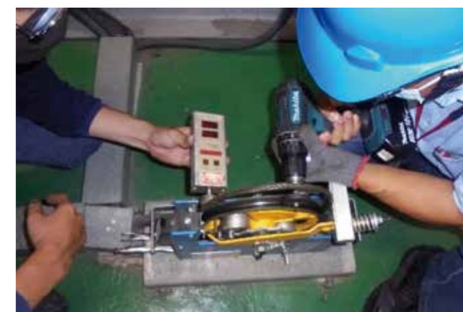
昇降設備管理人依規委託專業保養廠商按月保養維護
