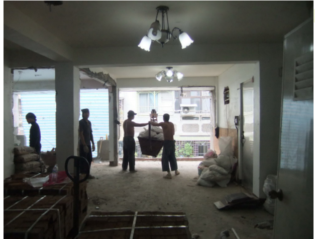
▲ 擅自拆除連接陽台之外牆（陽台外推）已構成違章建築行為
