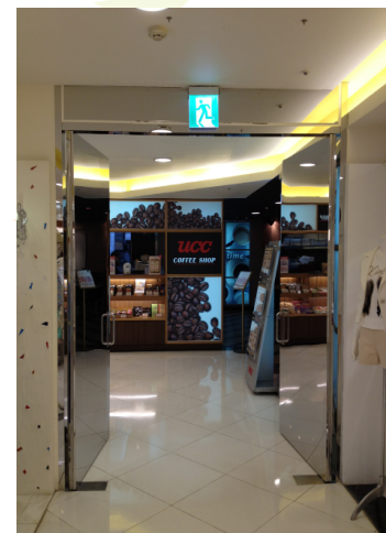
▲ 常時開放式防火門
