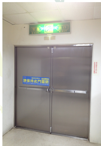
▲ 常時關閉式防火門
