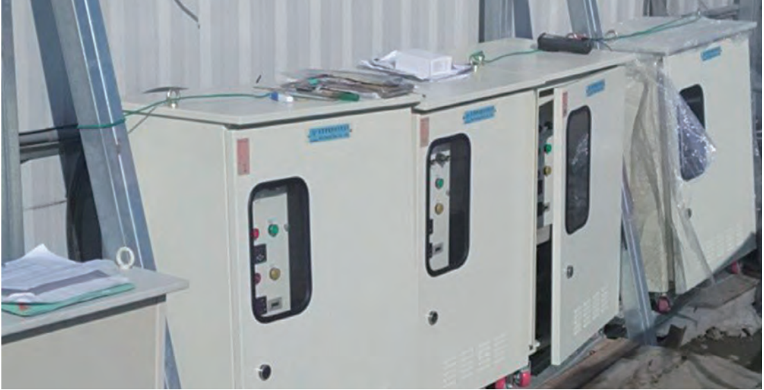
● 陸府建設陸府植森工地 四組怯水節能系統
