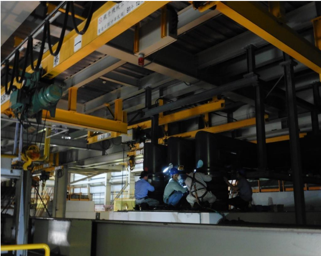
未配戴安全帶及未確實鉤掛安全帶之作業人員。
