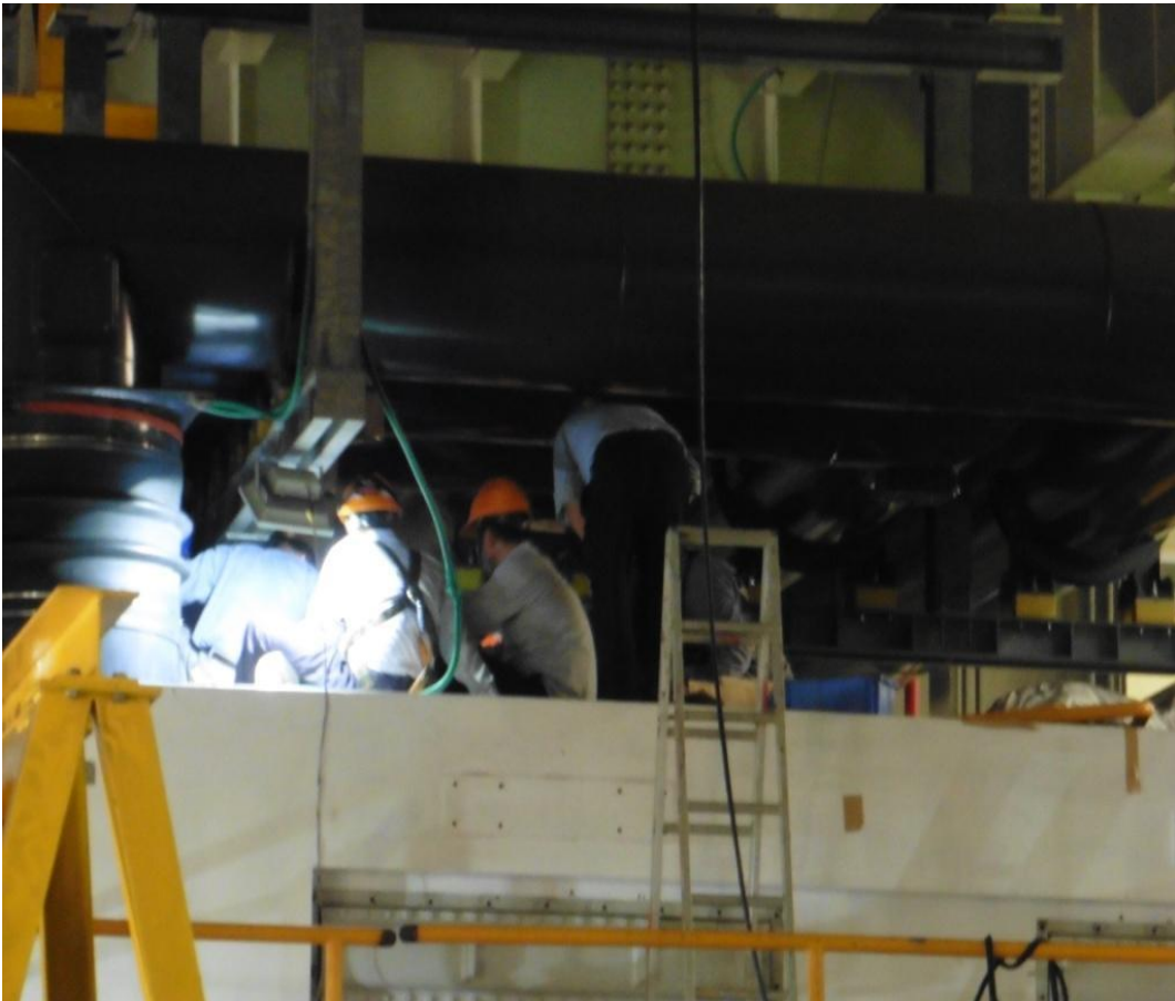
作業人員以合梯做為上下設備，未配戴安全帶及未確實鉤掛安全帶作業。
