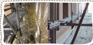
舊有：防墜網+延伸拖架設置(上左圖) 作法：延伸踏板+延伸拖架設置(上右圖)
