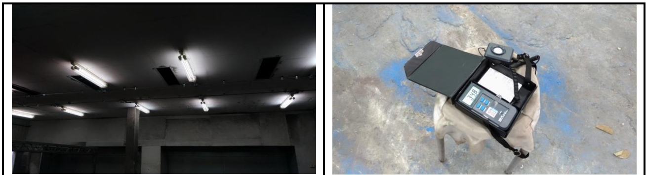
圖 3 改善後，區域 A 與 B 整體照明光度量測現況
