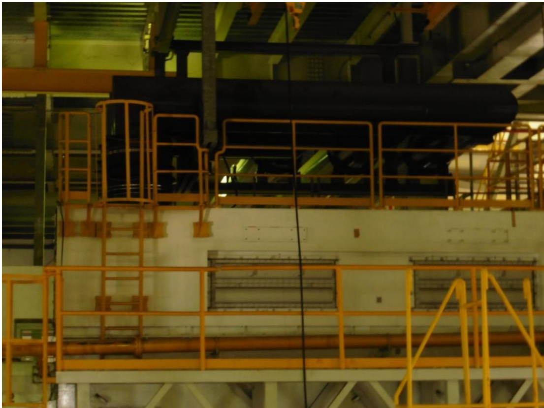
在機台上方及作業區四周加裝護欄，並設置含護籠的垂直梯之安全上下設備
